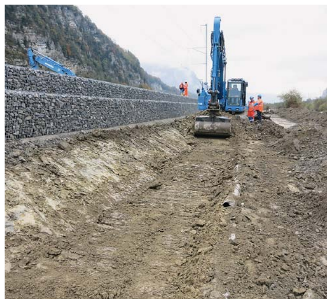
Absenkung des Vorlands
