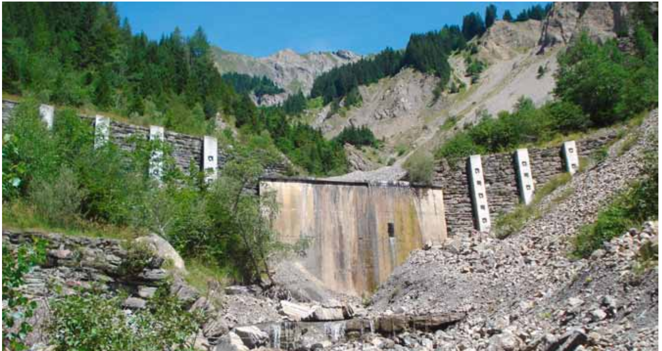
Sperre IVa am Lammbach
