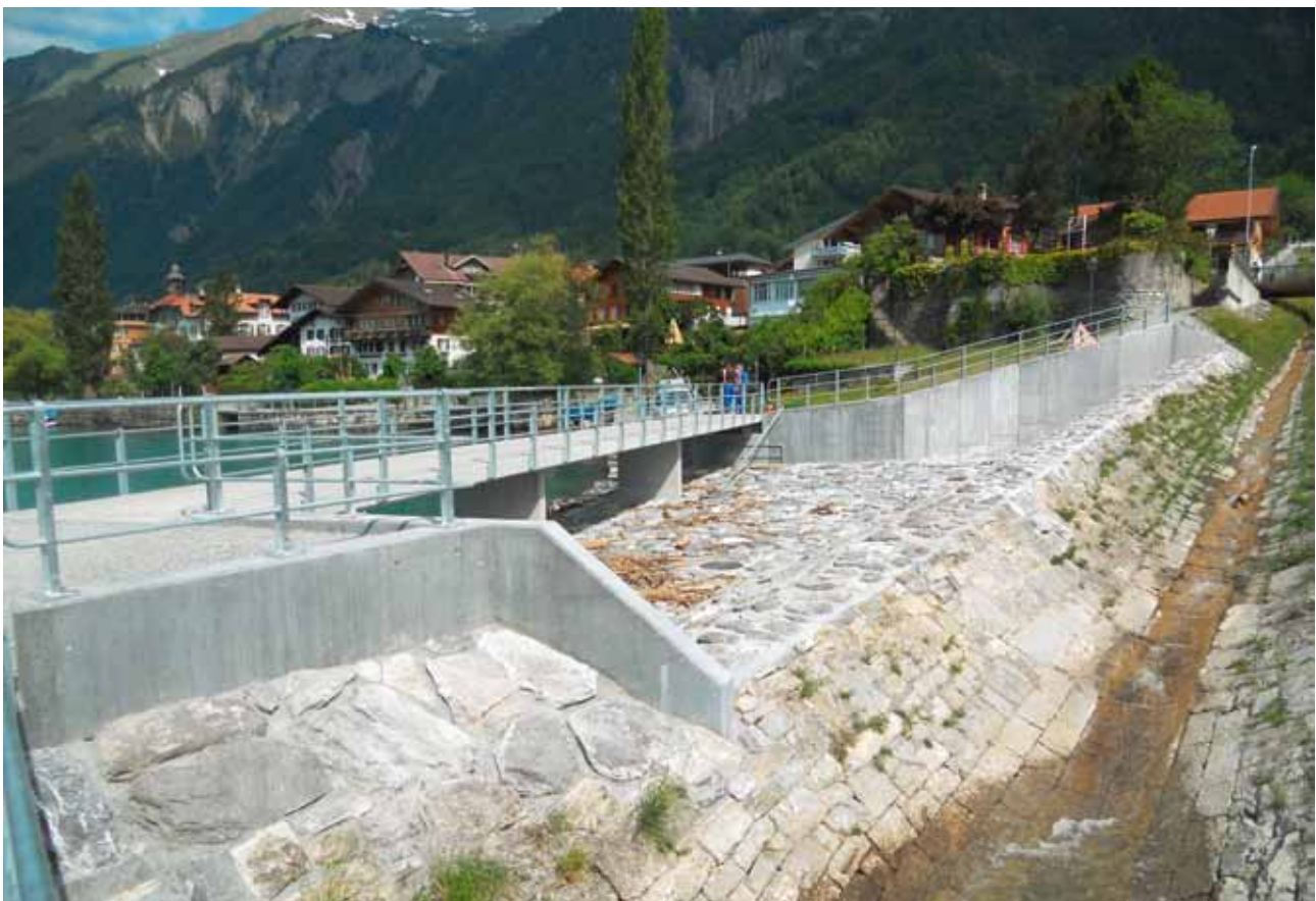
Abgesenktes Trachtbach-Gerinne mit Überlastrampe und Fussgängersteg
