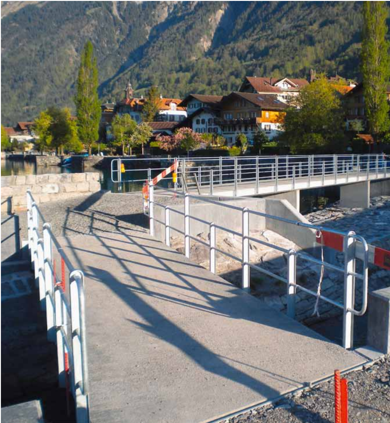
Die Brücke über den Trachtbach und der Fussgängersteg über die Überlastrampe wurden kurz vor Ostern fertiggestellt
