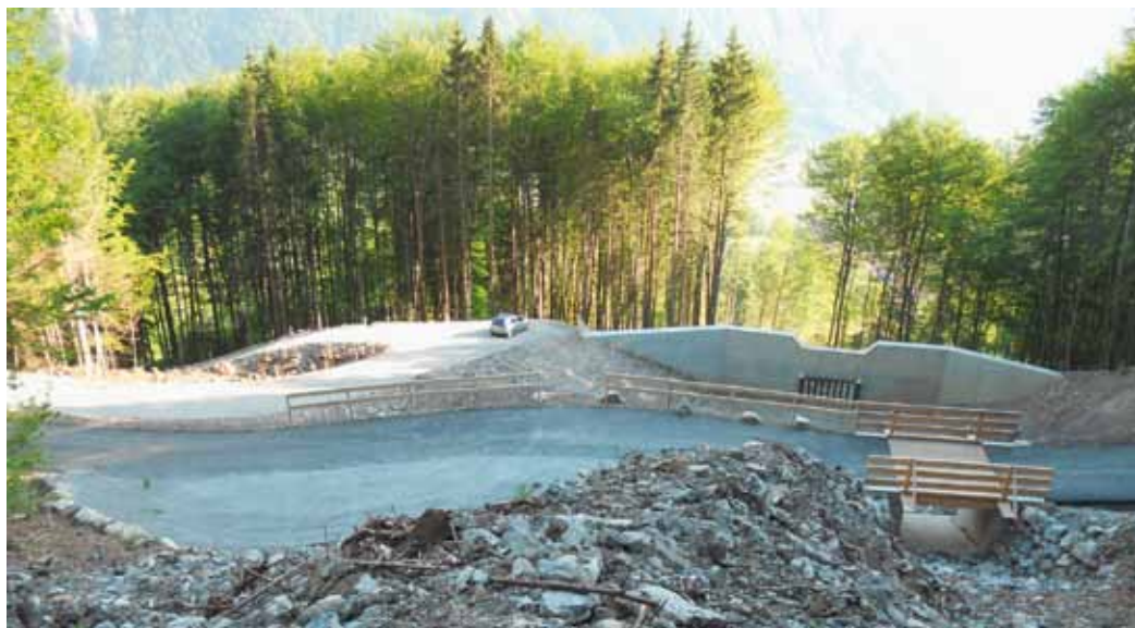
Leitdamm, Durchlass und Furt beim Geschiebesammler Hältiwald mit Zufahrtsstrasse
