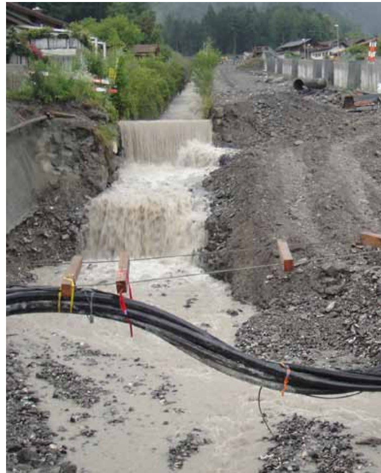
Die Glyssibach-Baustelle nach dem Gewitter-Ereignis Ende Juni
