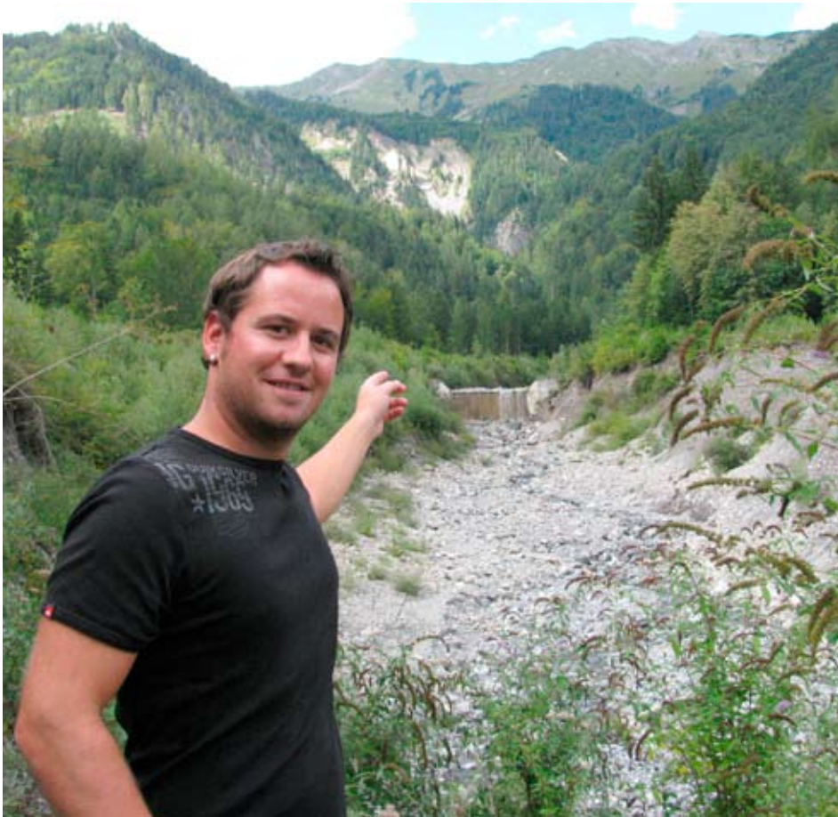
Marc Trauffer, Präsident der Schwellenkorporation Hofstetten, zeigt die sanierungsbedürftige Sperre 12.
